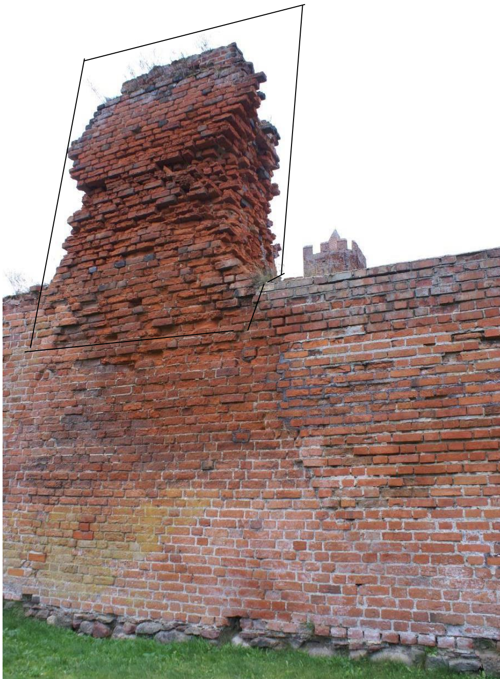
Fot 5 Relikt muru do konserwacji od strony pd-zach , stan : korozja strukturalna. Niezbędne od strony pd. przemurowanie 5 warstw poniżej linii zachowanego muru elewacji. Fot R Gazda'2019
